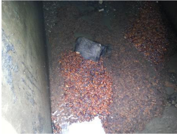
12) Grille avec regard bouché - Terrain de Tennis vers Eglise
