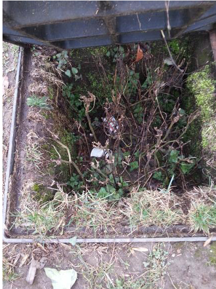
13) Regard avec paille/fumier - Croisement entre D11 et D280 (vers arrêt de bus)
