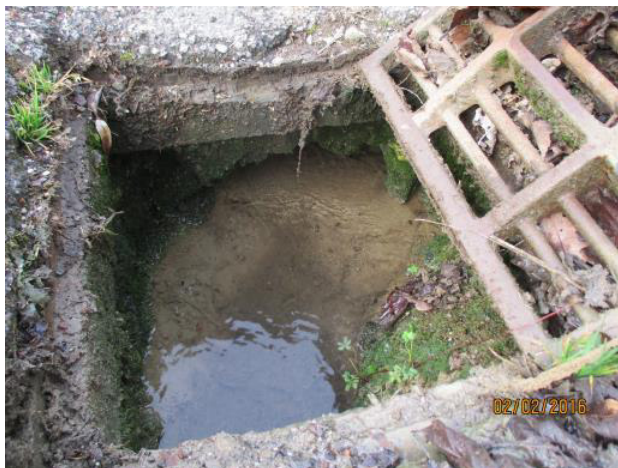
6) Grille recouverte de feuilles avec regard bouché - route du Soubon
